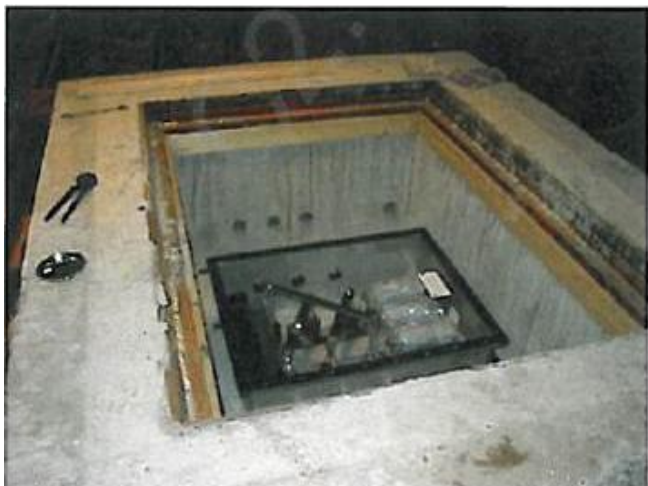
Figuur 2-10. Een mantelaardingskast in een aardput.
