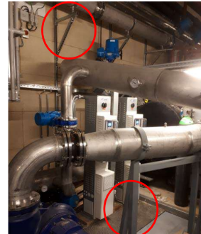
figuur 4 - nieuw leidingwerk is niet trillingsisolerend opgehangen/opgesteld
