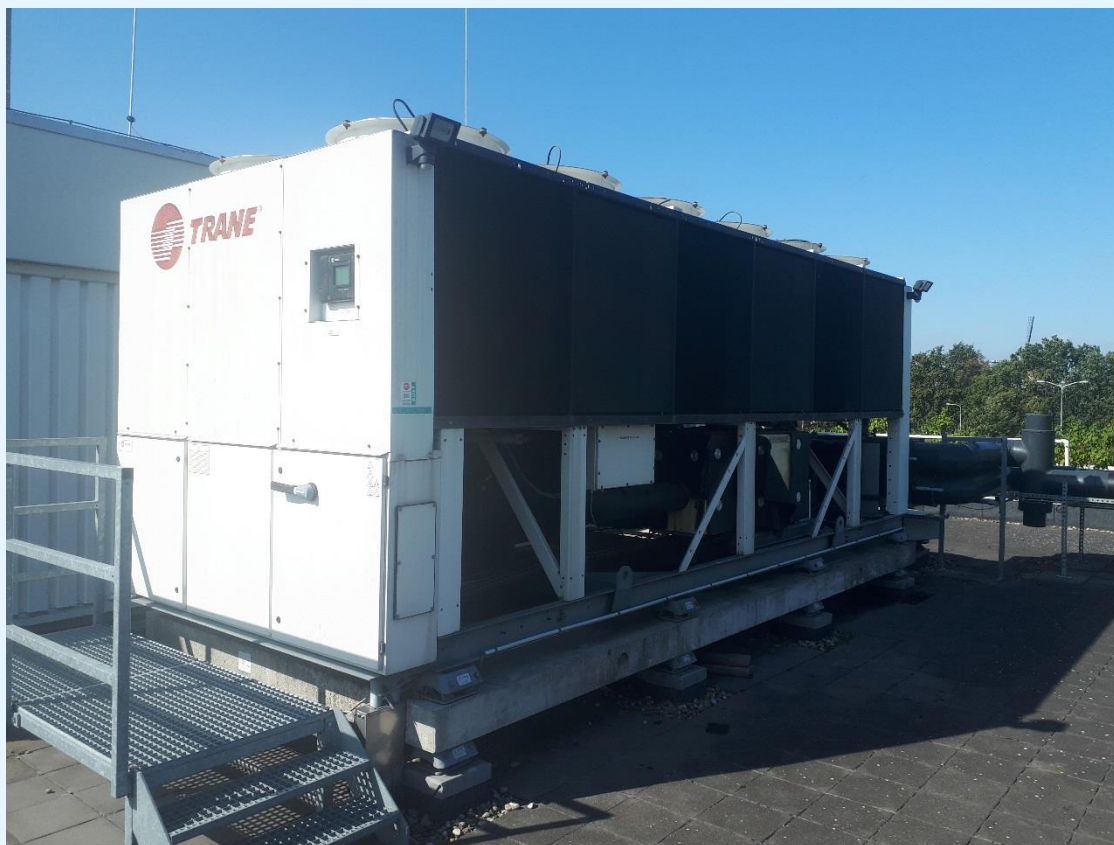
figuur 1: opstelling Trane koelmachine op dak Bravis Ziekenhuis
