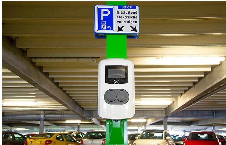
Laadinfrastructuur (Ziekenhuis Gelderse Vallei)
