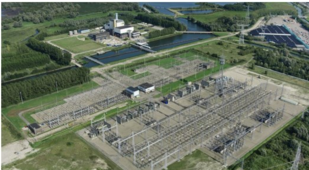
Figuur 2.3 Beeld 380-150 kV-hoogspanningsstation in Diemen (bron: TenneT)
