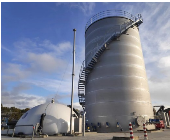
Figuur 4-6 CH 4 -reactor (rechts) met gasbuffer
