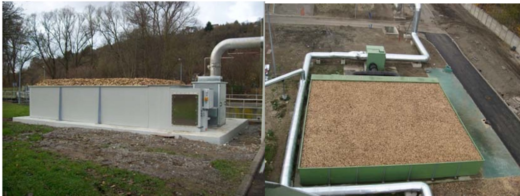
Voorbeelden van biofilters (bovenstaande biofilters zijn niet voorzien van een schoorsteen, bij BioLNG is een schoorsteen voorzien)
