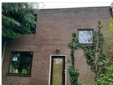
Figuur 2.14 Bedrijfswoning met smalle open stootvoegen in gevel.
