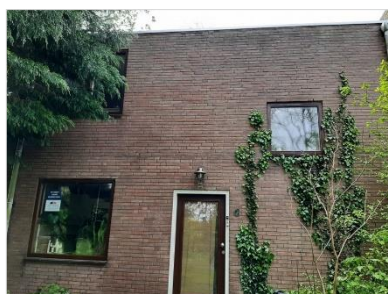
Figuur 2.10 Bedrijfswoning met smalle open stootvoegen in gevel.
