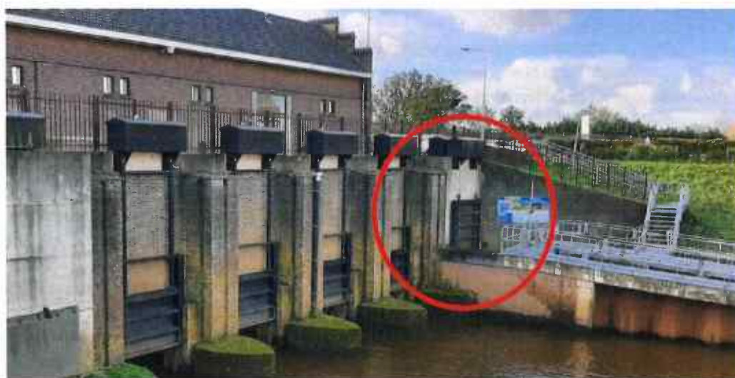
Figuur 4-1: Aanzicht op buitenzijde Gemaal van Sasse met locatie schuiven bij vispassage rood omcirkelt
