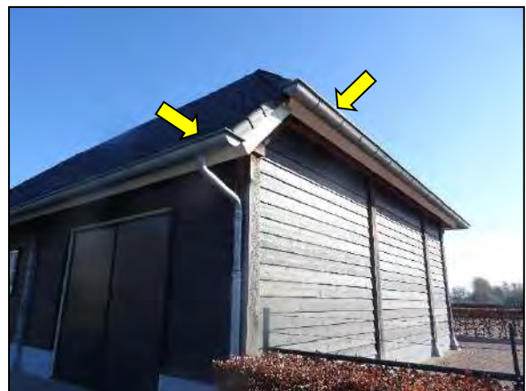
Figuur 16. Toegang naar ruimtes onder de dakpannen voor huismus via de dakgoot (bijgebouw op perceel woonhuis).
