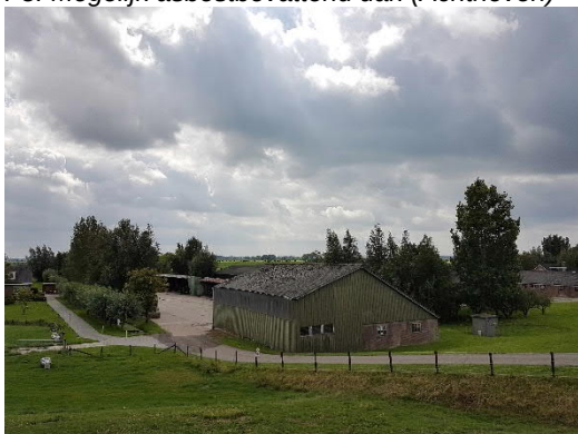
F7: Mogelijk asbest bevattend dak (Bergstoep, Streefkerk)
