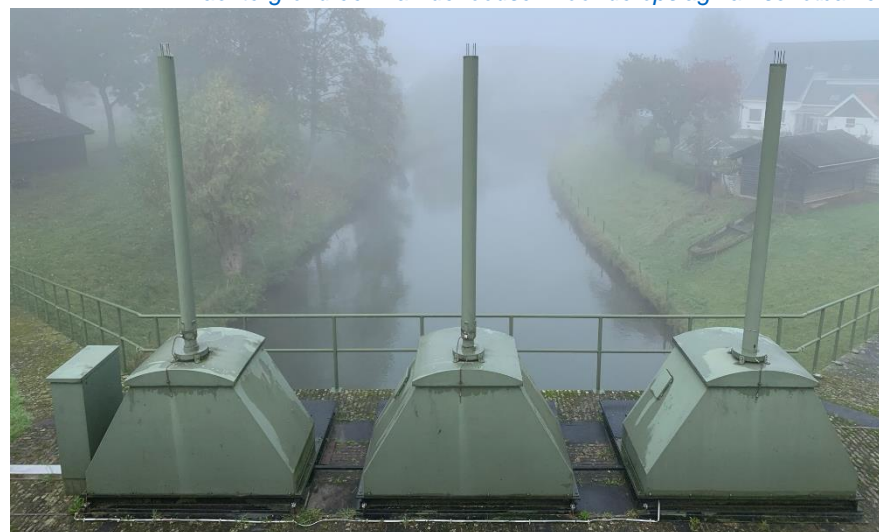
Figuur 2-5 Zicht op de motorische bediening van de stalen schuiven, met op de achtergrond een van de loodsen voor de opslag van schotbalken.
