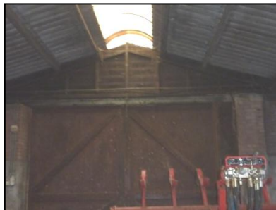
Figuur 17. Achter gevelbetimmering aan de nok is geen besloten ruimte.
