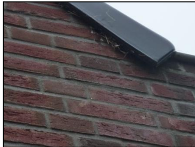
Figuur 10. Nest spreekw onder dakpan.
