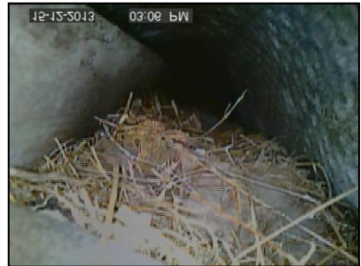
Figuur 11. Nestrest huismus onder golfplaten dak.
