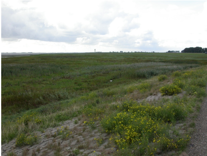
Figuur 3-2 Voorbeeld steenbekleding
