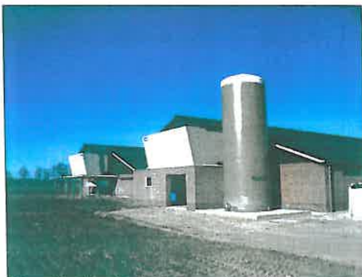
Figuur 3: Luchtwasinstallatie kopse gevel westzijde.
