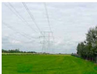
Afbeelding 20: Huidige 380 kV tussen Geertruidenberg en Tilburg
