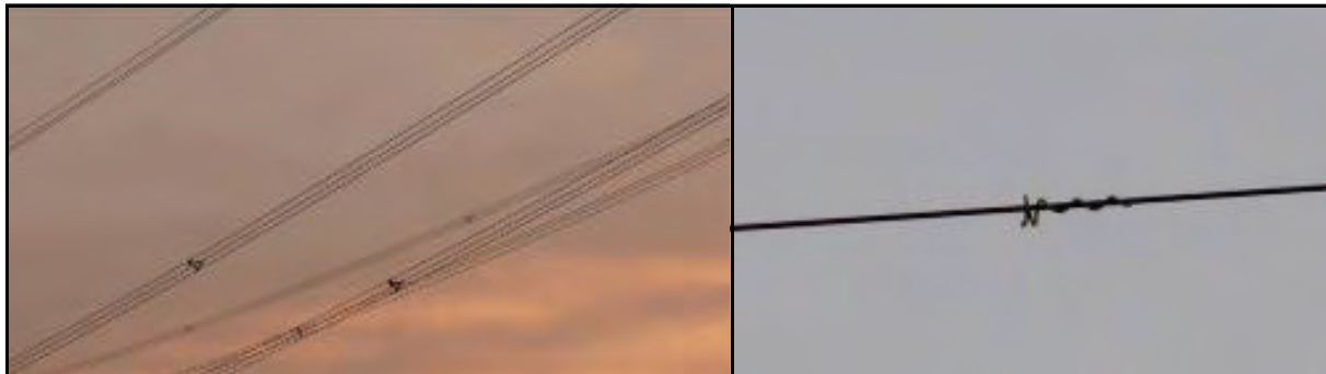
Figuur 16.4 Markeringen in de bliksemdraad van een 380 kV verbinding (links: afstandhouders, rechts: varkenskrullen)
