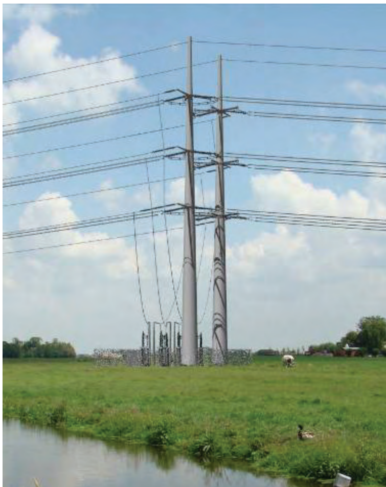
Figuur 7.6 Impressie van opstijgpunt 150 kV behorend bij een Wintrackmast
