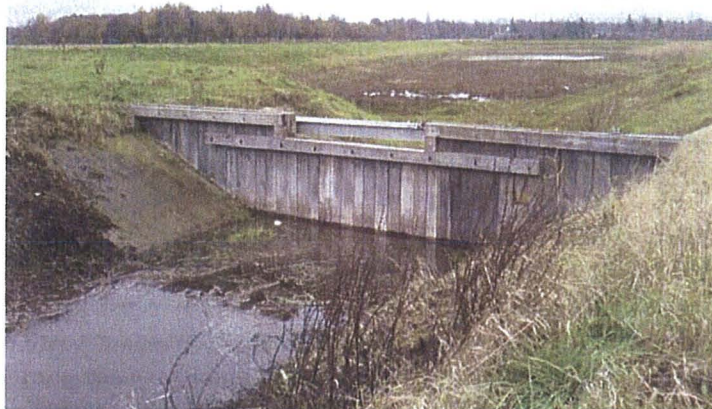
figuur 2-7 foto instroomvoorziening bergingsvoorziening industrietrein Vorstengrafdonk
