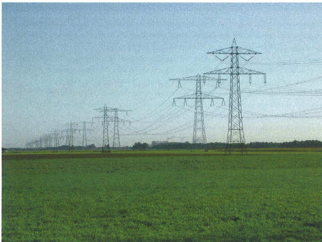
Foto: Hoogspanningleiding in Arenbergpolder
